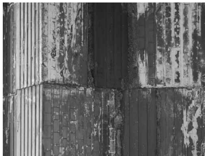
Vápenné výkvěty na silně promočeném zdivu. Po vyschnutí zdiva se vápenné výkvěty odstraní např. drátěným kartáčem.
