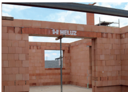
8. Příklad pro otvory se světlostou šířkou \geq 2,5 m se montážně podepřou před zahájením dalších prací (vyzdívání zdiva nad překladem, uložení stropů apod.).
