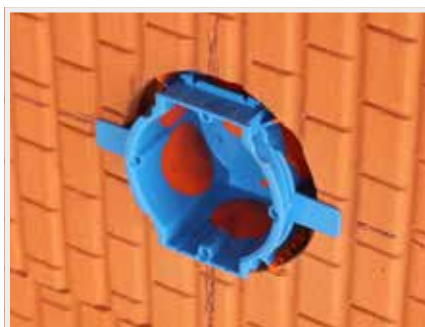
8. Osazená samostatná krabice fixovaná rohokovými zuby
