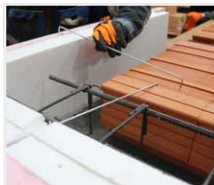
18. Před betonáží se velké spony zatlučou jedním koncem do věncovky RAPID a druhým koncem do vložky HELUZ MIAKO.
