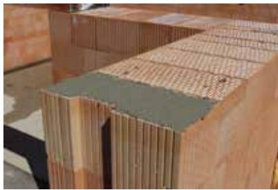
⑤ Zdivo se v místě uložení překladu namaltuje tenkovrstvou maltou HELUZ SBC v tloušťce 3 mm.
