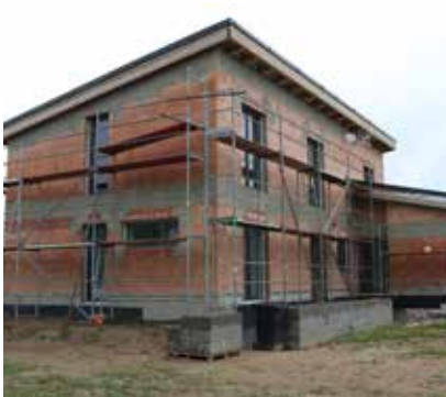
④ Příprava stavby před omítáním. Před omítáním se případně vyspraví zdivo a ošetří se exponovanější místa konstrukčních detailů.
