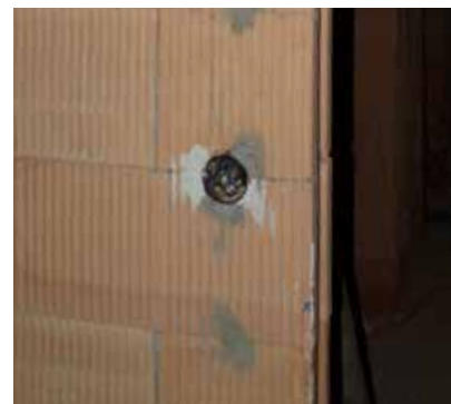
Pro rozvody kabelů např. v příčkách je výhodné použít díry v cihlách. Tím dochází k omezení množství prováděných drážek.
