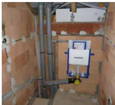
Rozvody vody a kanalizace se doporučuje do zdiva nezabudovávat. V místě „stoupaček“ se doporučuje zdivo omítnout před instalací technických rozvodů.
