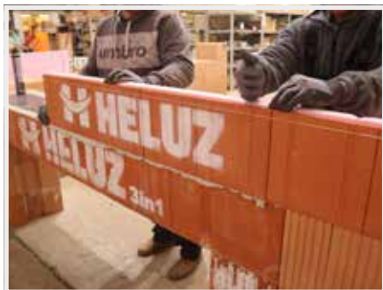
10. Je vhodné po založení rohů na každou stranu stěny připevnit další dvě věnčovky.
