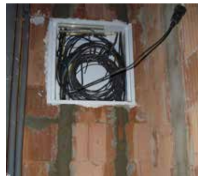
Rozvody by před omítnutím měly být řádně zapraveny maltou.
