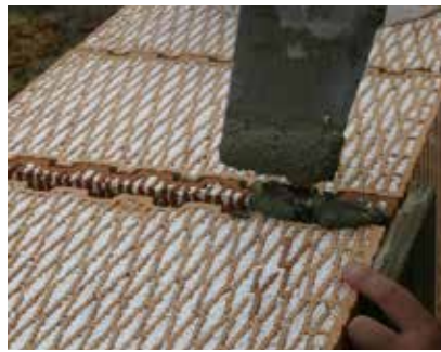
Mezeru mezi cihlami, je nutné vyplnit maltou nebo dořezem cihly a promaltováním (v případě zdění na PU pěnu výjimečně propěněním dvěma housenkami).
