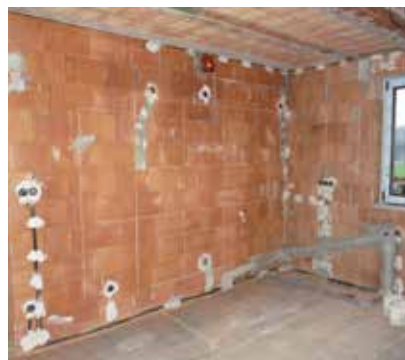
Pohled na zabudované elektroinstalační krabice a rozvedené kabely. Drážky pro rozvody vody a kanalizace musí být co nejmenší.
