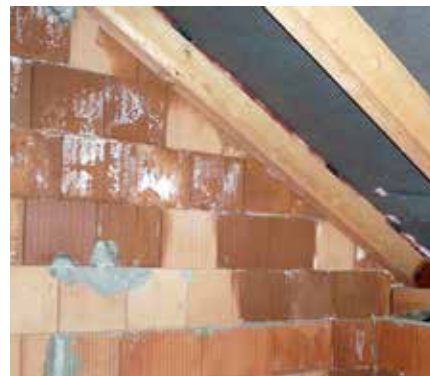
Výkvěty na vlhkém zdivu je potřeba po vyschnutí mechanicky očistit.
